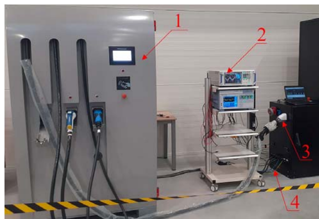
Rys.7. Ładowarka w trakcie testów na układzie
