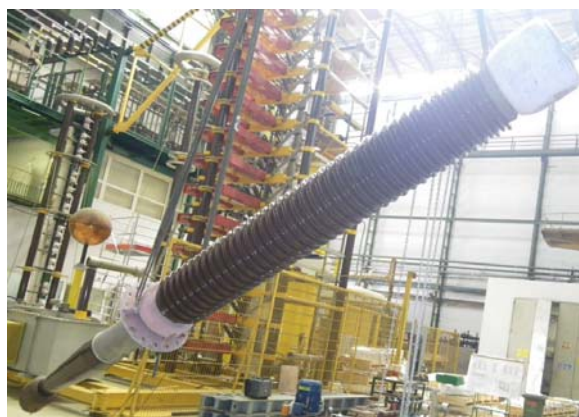
Rys.1. a) Transformator blokowy (zdjęcie Energoserwis SA, obecnie EthosEnergy), b) izolator przepustowy 400 kV typu OPI (zdjęcie własne)
