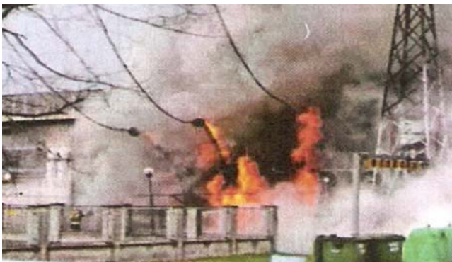
Rys.4. Płonący transformator (zdjęcie otrzymane z Elektrowni)
