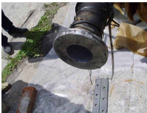
Rys. 7. Skutki pożaru: a) pokrywa kadzi jest podniesiona na 80 mm (zdjęcie z firmy EthosEnergy), b) spalony izolator, c) kanał zwęglonej izolacji fazy L2, d) opalony pierścień izolatora fazy L2 (b, c, d - zdjęcia własne)
