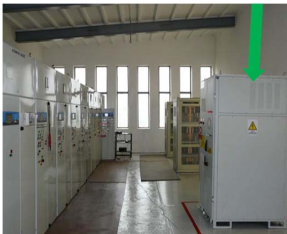
Rys. 6. Super kondensatorowy zasobnik energii.
