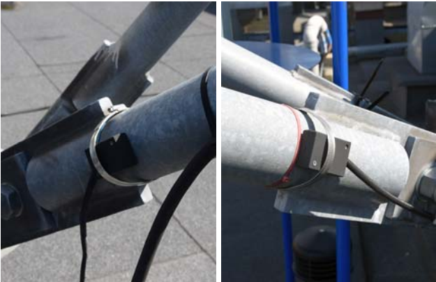
Rys. 8. Rozmieszczenie czujników drgań: na początku ramienia konstrukcji oraz czujnika referencyjnego na niewykorzystanej konstrukcji wsporczej elektrowni wiatrowych
